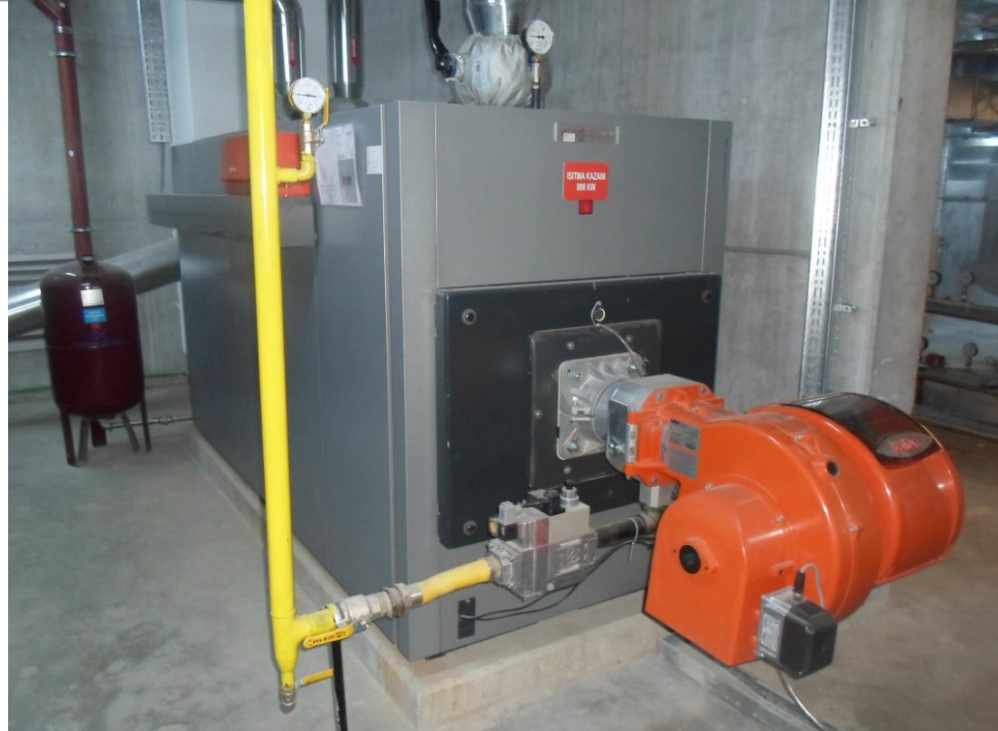
Tesisat merkezi : Dođalgaz kazanı
