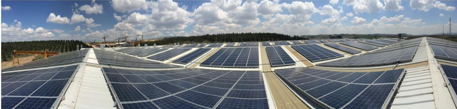
Güneş elektrik sistemi (solar PV sistemi)
