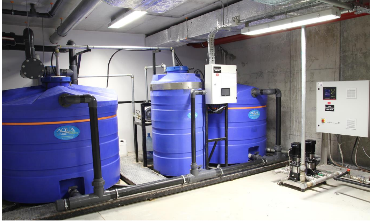
Tesisat merkezi : Paket tip gri su sistemi.
